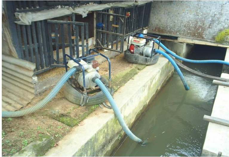
Gambar 15. Pompa penyuplai air pada kolam air deras
