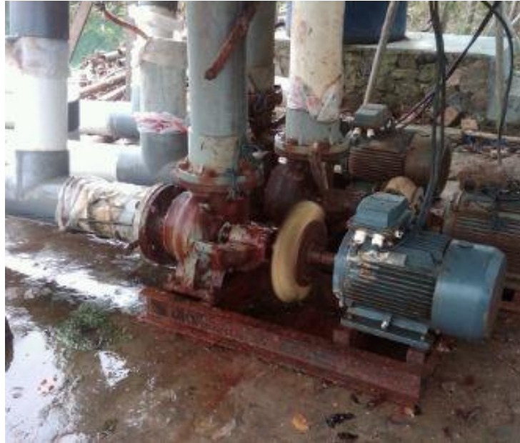
Gambar 28. Pompa axial untuk menyalurkan air tambak.
