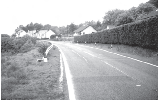
Gambar 7 Permukaan Jalan Raya Harus Dibuat Kasar Agar Kendaraan yang Melintas di Atasnya Tidak Tergelincir. (Sumber: Haryana, 2006)
