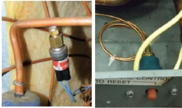
Gambar 5.14 Low-pressure Switch pada Unit Tata Udara Domestik
